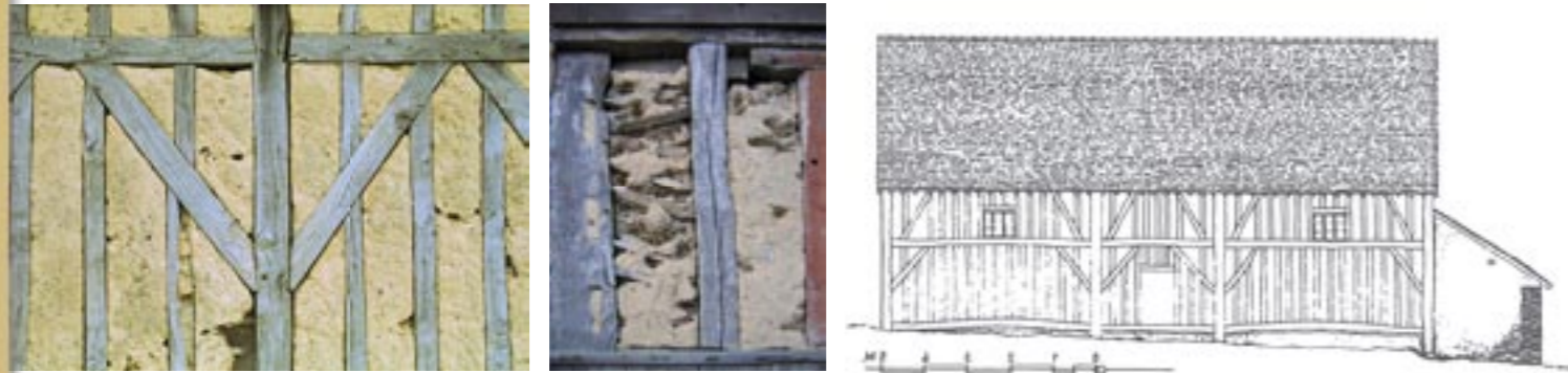
Entre les montants de bois, la disparition du torchis laisse apparaître les pièces intermédiaires (ou éclisses) qui servent à assurer une meilleure adhérence de la terre entre ces montants
